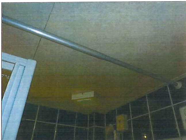
Foto 7: Badkamer: Ventilatiekanaal (Niet asbestverdacht)
