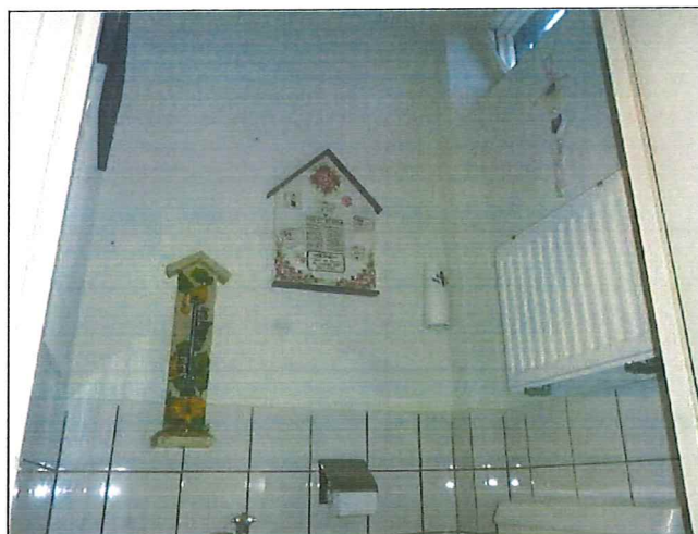
Foto 14: Toilet, wanden: Tegellijm (Ontoegankelijk)
