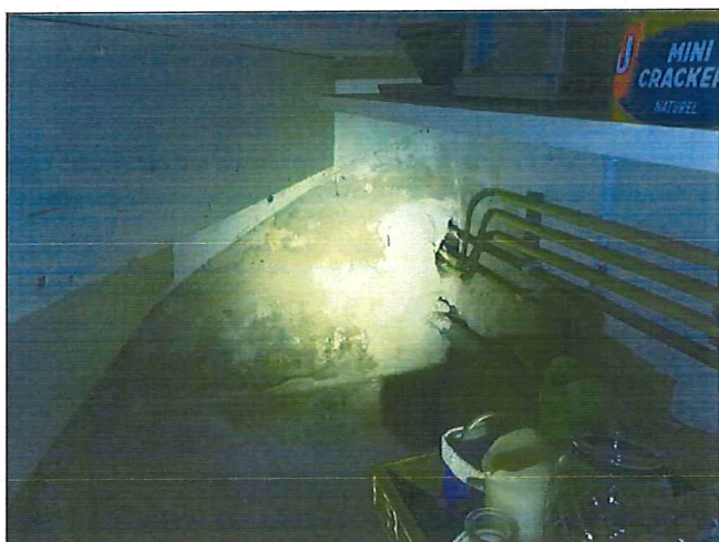
Foto 17: Trapkast: Leidingwerk (Niet asbestverdacht)
