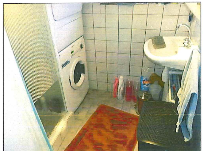
Foto 6: Badkamer, wanden: Tegellijm (Ontoegankelijk)
