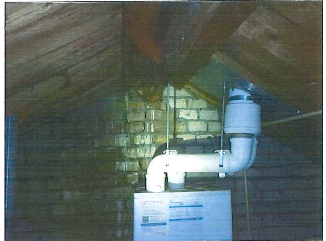
Foto 2: Zolder: CV-ketel (Niet asbestverdacht)
